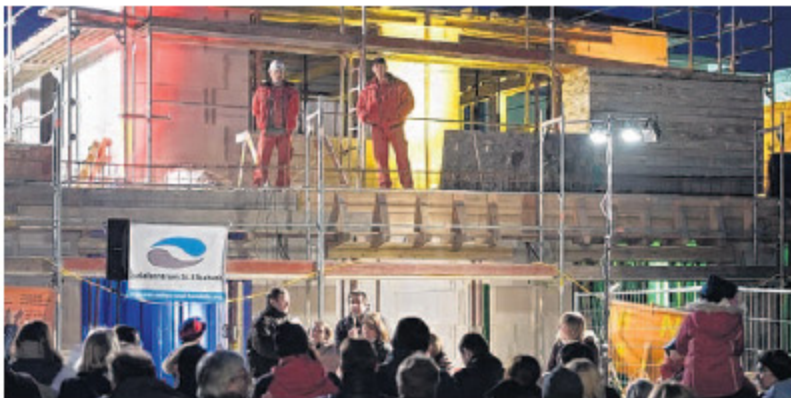
Das Sozialzentrum St. Elisabeth im Heidelberger Süden nimmt Gestalt an. BILD: ROTHE
